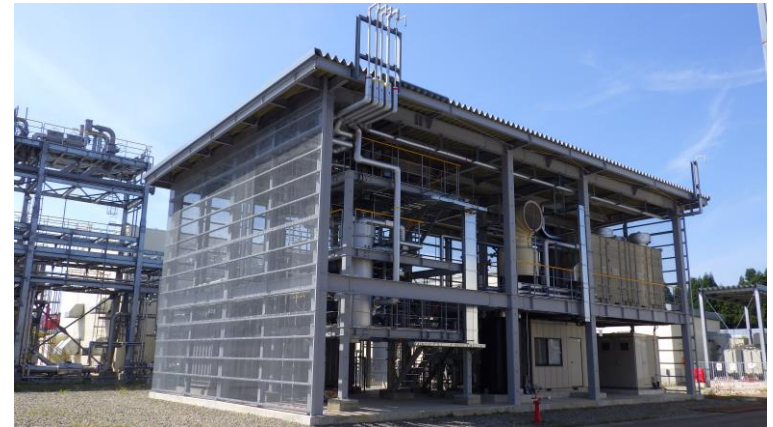
【INPEX・長岡鉱場のメタネーション実証設備】
