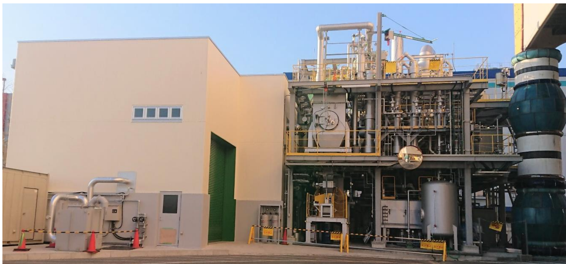
次世代型廃棄物処理システム 実証プラント
