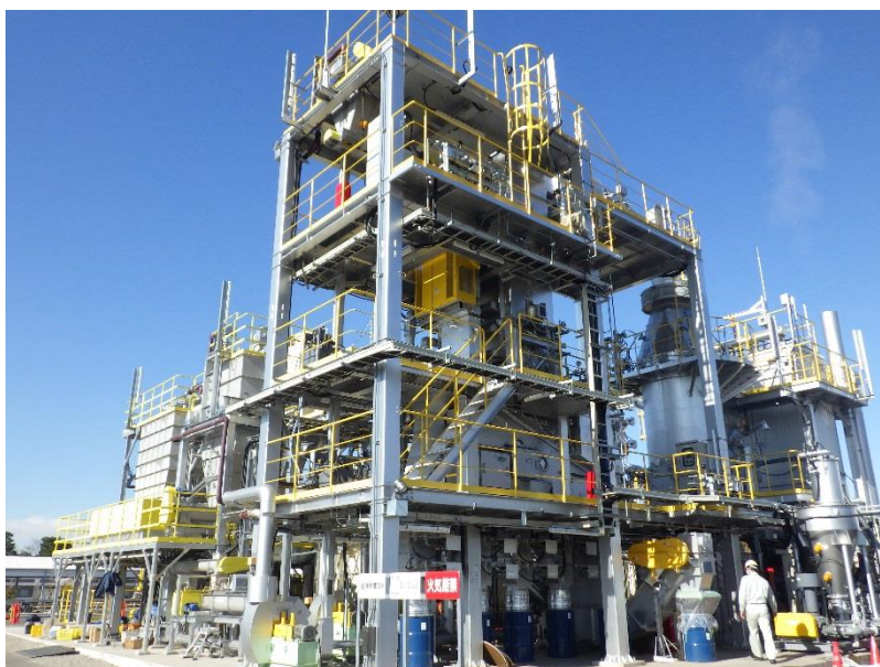
試験設備（外観）
