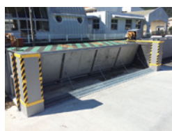
● フラップゲート式水害対策設備
