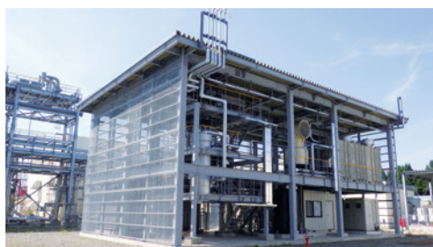
メタネーション 試験設備
