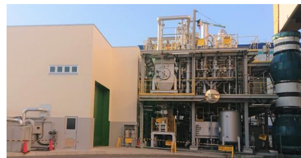
次世代型廃棄物処理システム 実証プラント
