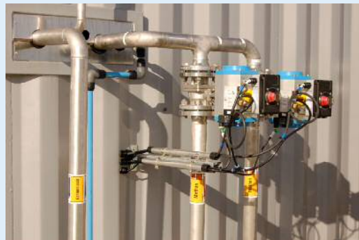
バイオガス精製装置
