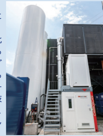
©Regionalwerke AG Baden CO 2 液化施設(スイス)
