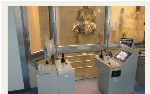
図3 ごみクレーン操作卓の例
