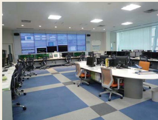
写真3 SPring-8 中央制御室
