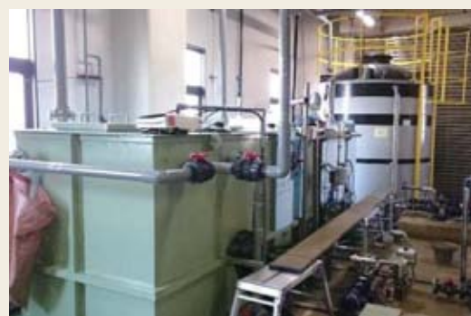
図5 脱水分離液槽(奥)と硝化脱窒素槽
