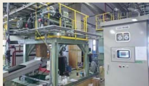
図4 遠心脱水機(左)と制御盤
