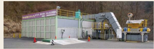
図2 受入・前処理設備の写真
