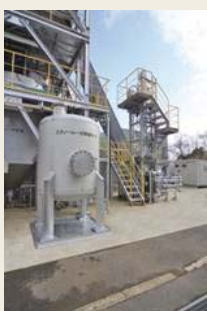
図5 蒸留設備の写真
