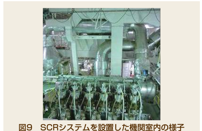
図9 SCRシステムを設置した機関室内の様子
