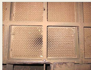
図14 触媒入口の状況(パージ後)
