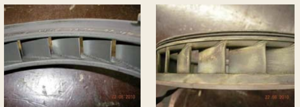
図11 高負荷運転後の過給器のノズルリング
