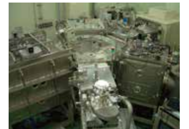
有機 EL 製造テスト機 OLED production test machines
