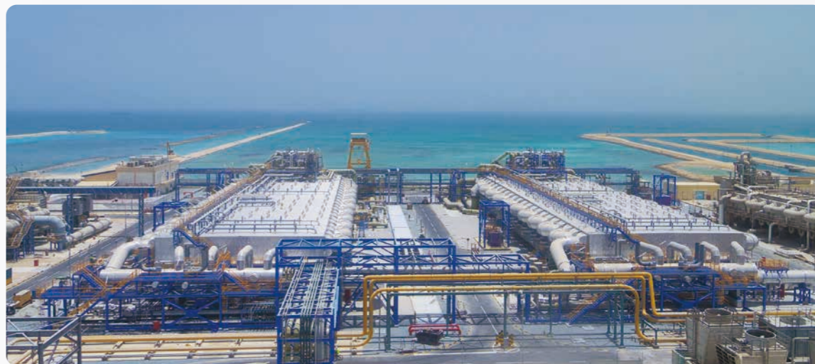
蒸発法海水淡水化プラント(カタール)
