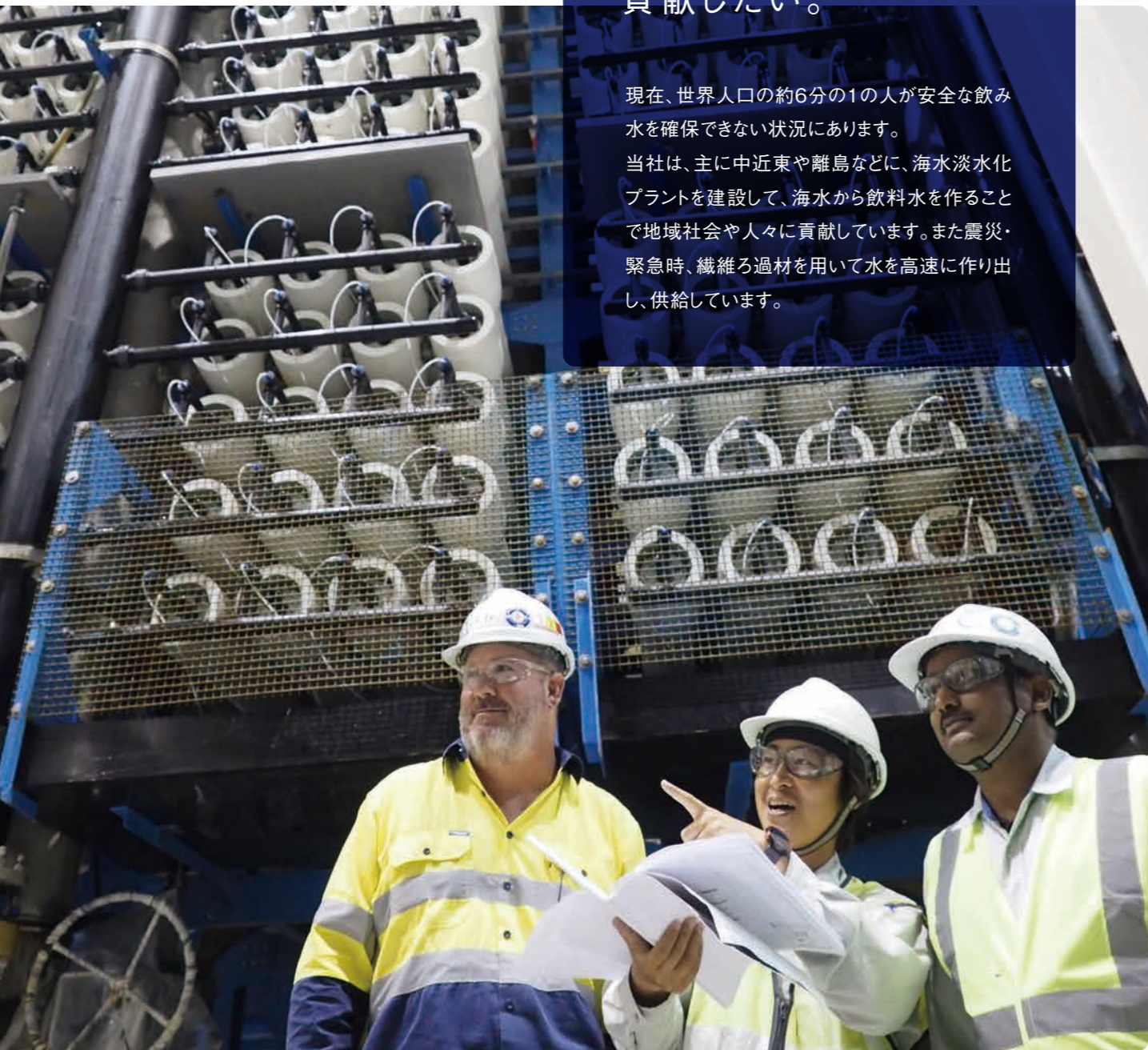
RO式海水淡水化プラント(カタール)
