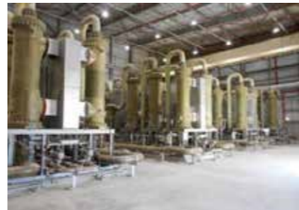
海水電解装置 Electro-Chlorination System
