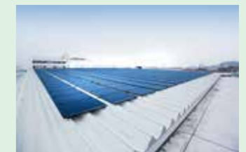
太陽光発電システム (総出力 133kW) Solar Panels (133 kW system)
